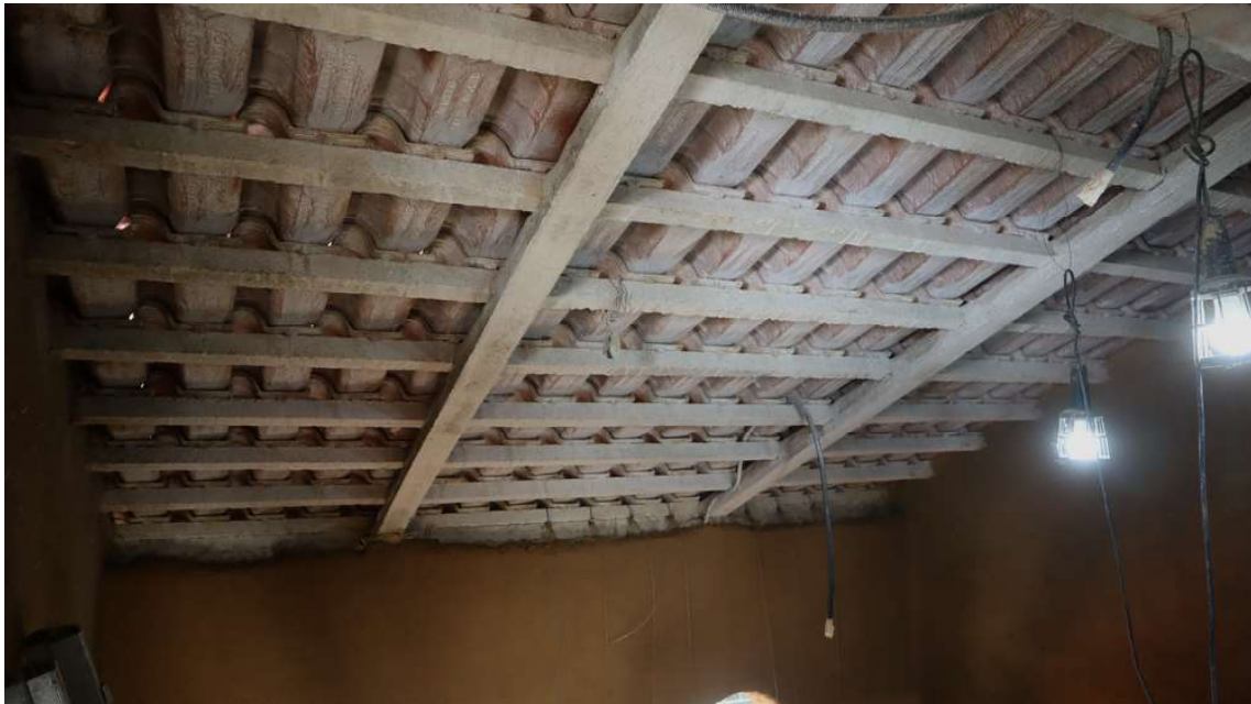
Figura 1. Techo de la cubierta existente. Las tejas están directamente aplicadas sobre la estructura ninguna capa de aislación térmica
