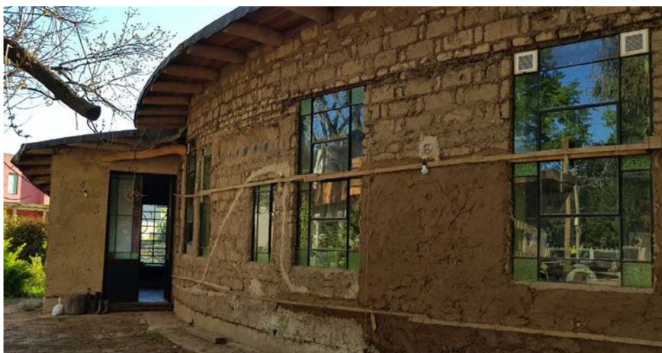
Figura 1. Pared de adobe “traba hueca” portante con revoque regleado a plomo, Proyecto J&M en Buenos Aires, Argentina (crédito: M. Aresta)
