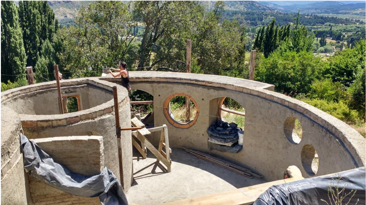
Figura 6. Obra de la vivienda “Susurros del Viento” en el Hoyo, Chubut, Argentina. Terminación del rasado final del encadenado superior de la pared de adobe (crédito: M. Aresta)
